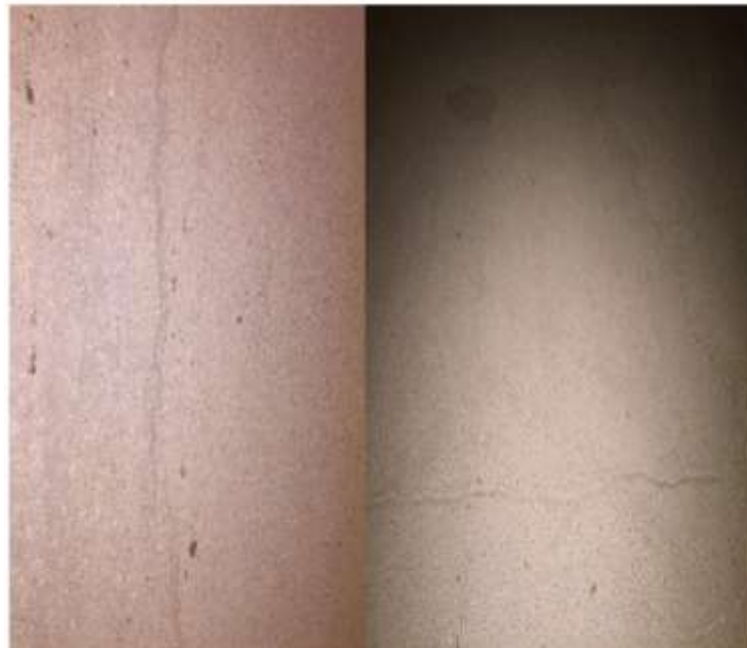
a. Longitudinal crack
